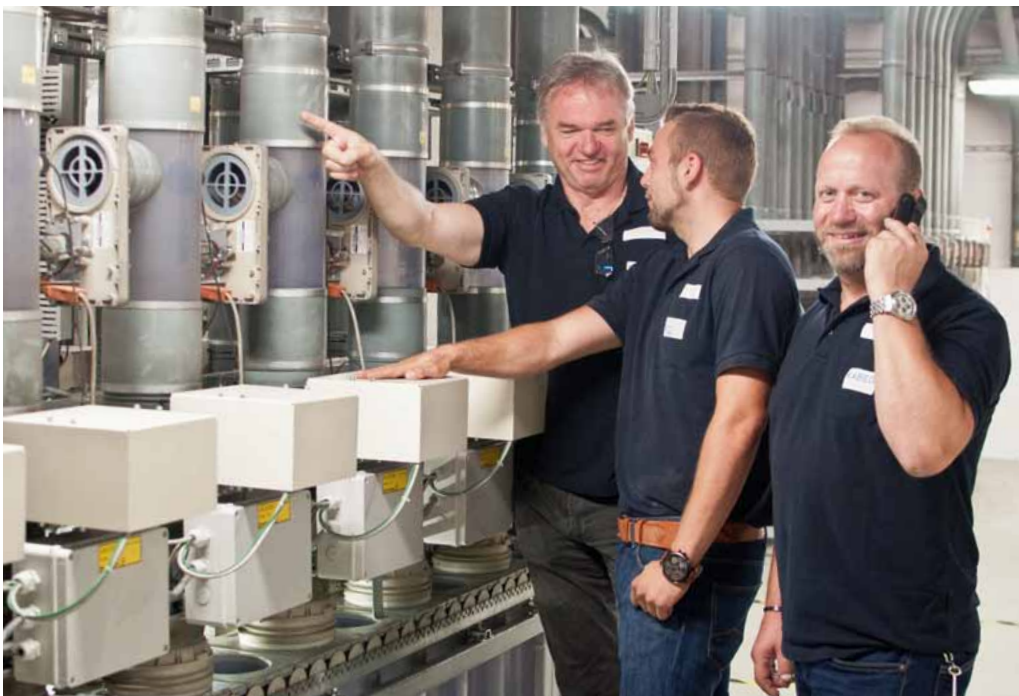
Das Team vom Technischen Betriebsmanagement wartet das rund 40 Kilometer lange Rohrpostsystem. Es wurde 1992 installiert und wird ständig weiter ausgebaut.
